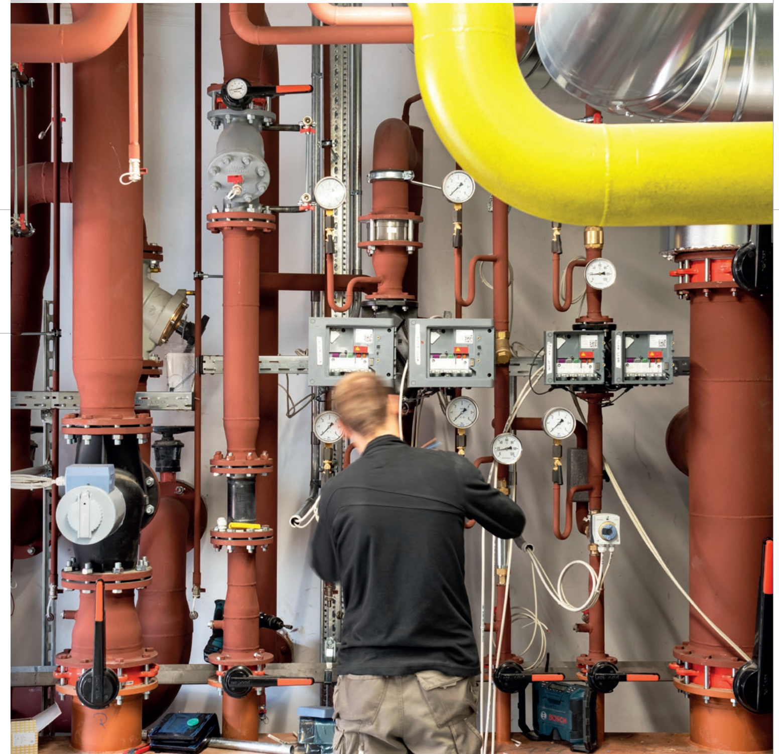
Ein umweltfreundliches Blockheizkraftwerk beheizt in Zukunft die Wohnungen in Luz 5 & Luz 6. Über diese ökologische Energieversorgung freuen sich seit Sommer 2020 bereits Eigentümer und Mieter des ersten Bauabschnitts der G.O.L.D. Gartenstadt Olympisches Dorf von 1936®.
